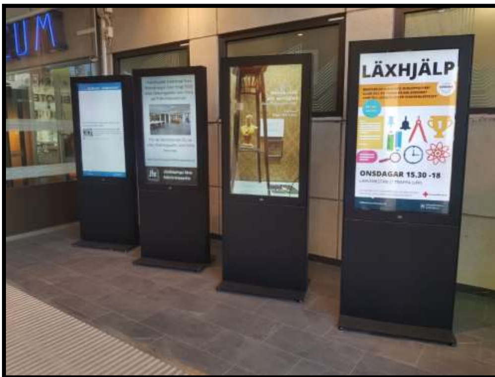
Informationsskärmar i entrén vid Stadsbiblioteket och Läns museet. Foto: Lars Östvall.
